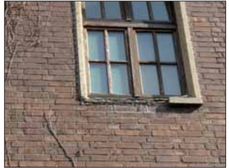
Die Bergschule heute - Gebäudeschäden
