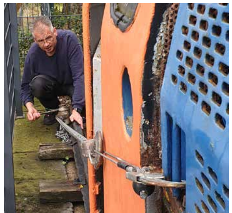
Selbst die Motorabdeckungen sind festgerostet und müssen aufwändig gelöst werden.
